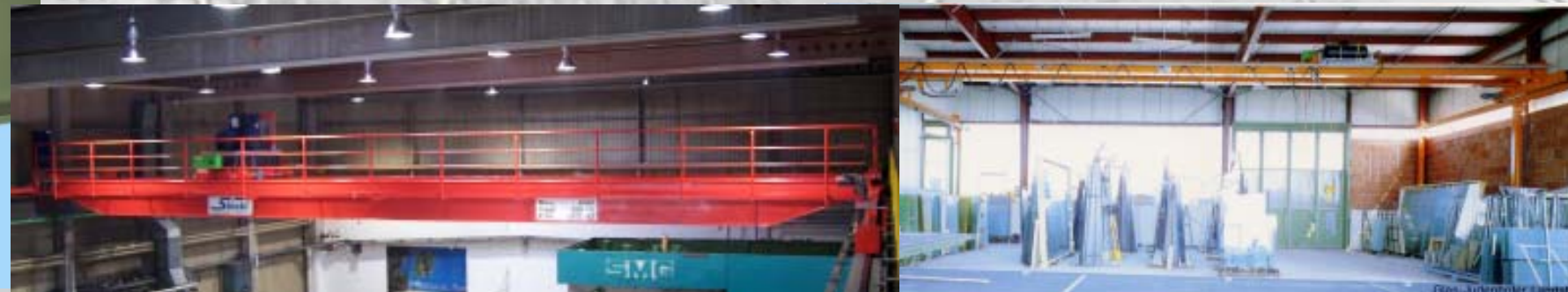
Nachträglich eingebauter aufgeständerter Zweiträgerkran mit Seilzug. (Zusätzliche Druckluftanlage).
